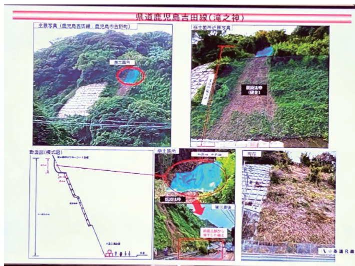
滝之神の法面(急斜面)の状況
